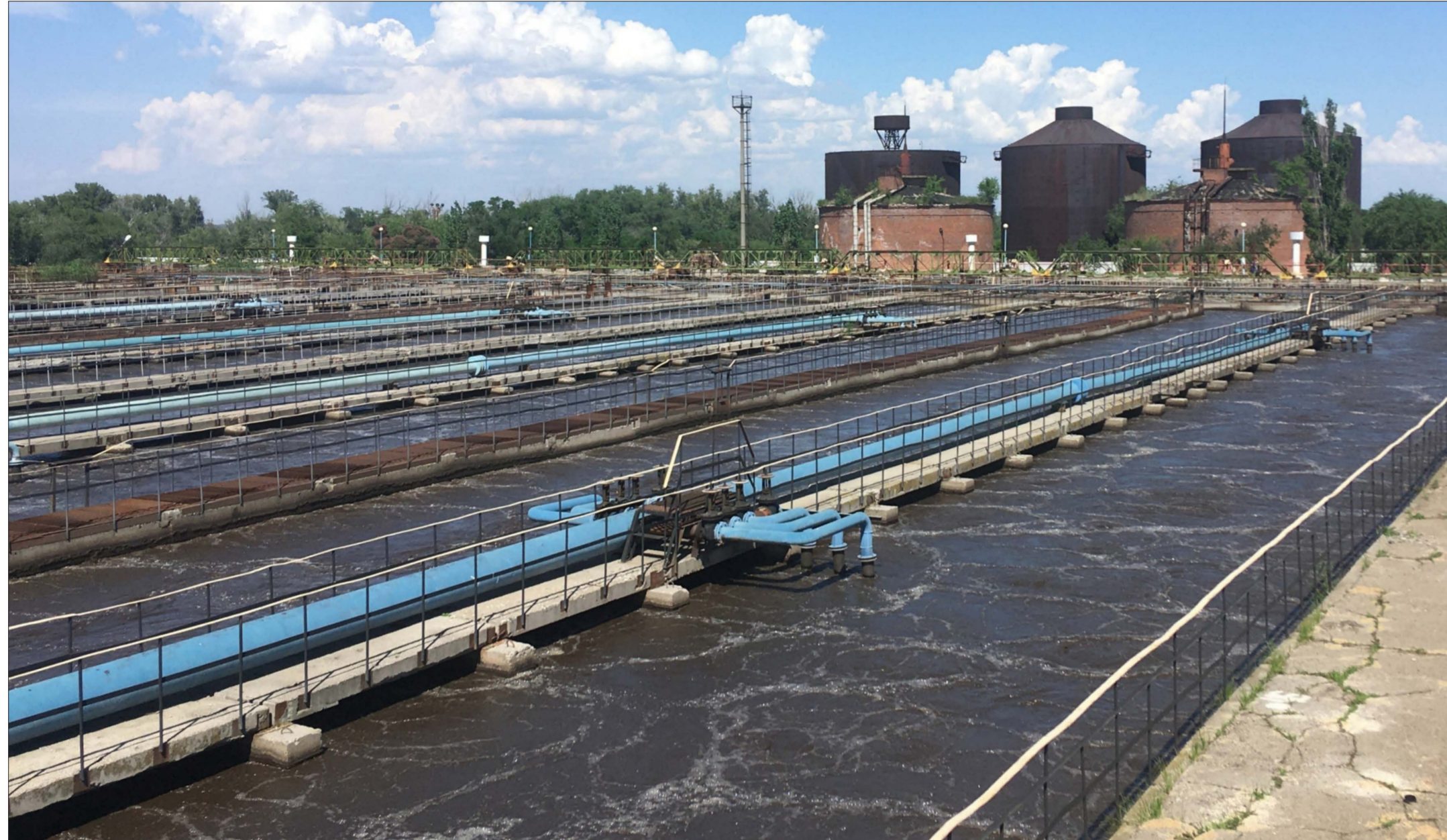
По своим размерам система городской канализации с системой коллекторов и очистными сооружениями — самое большое производство в городе. А её значимость для комфорта и здоровья горожан переоценить невозможно.
