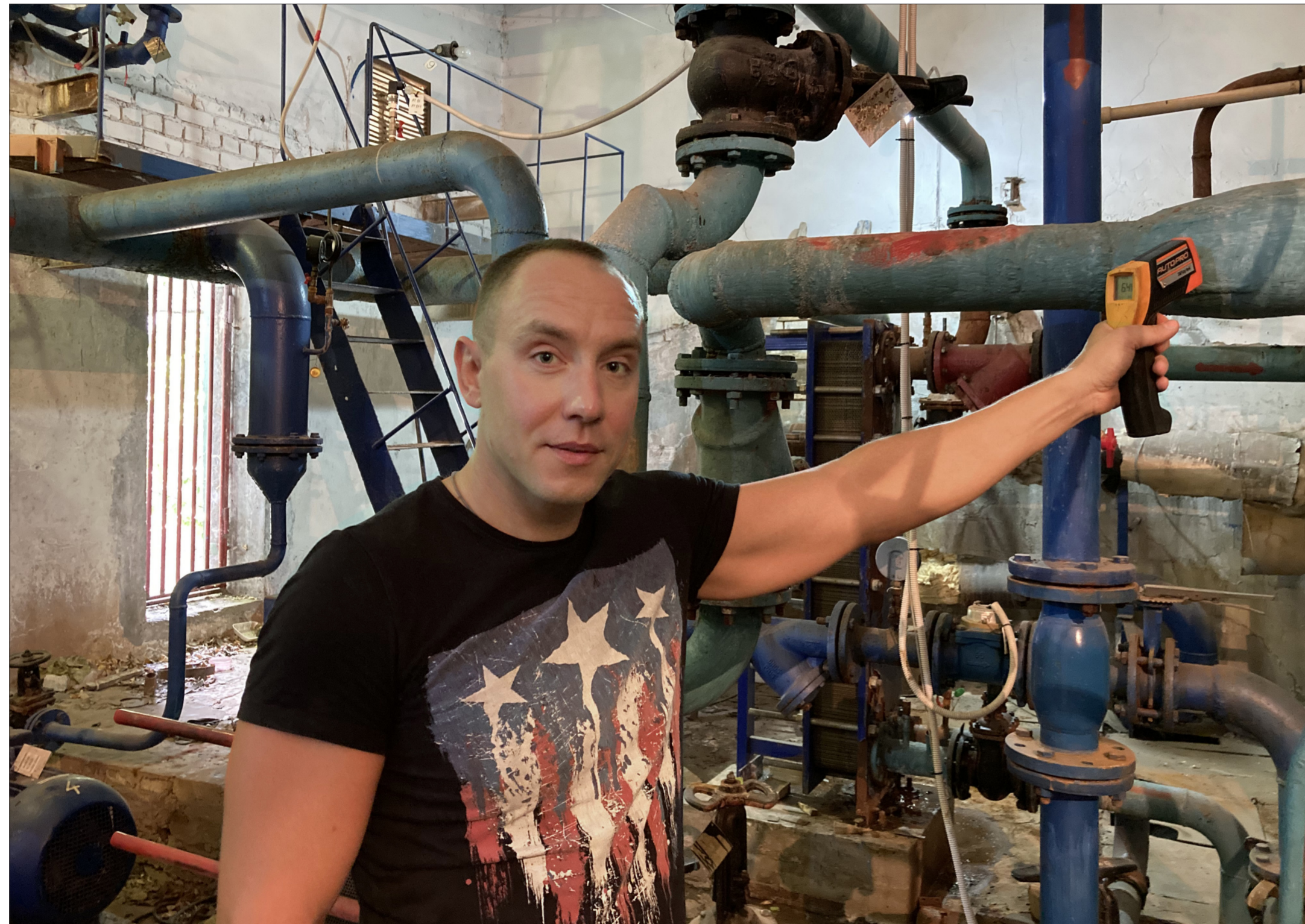
Каждый день Илья Кучаев проверяет тепловые сети и оборудование ЦТП.
