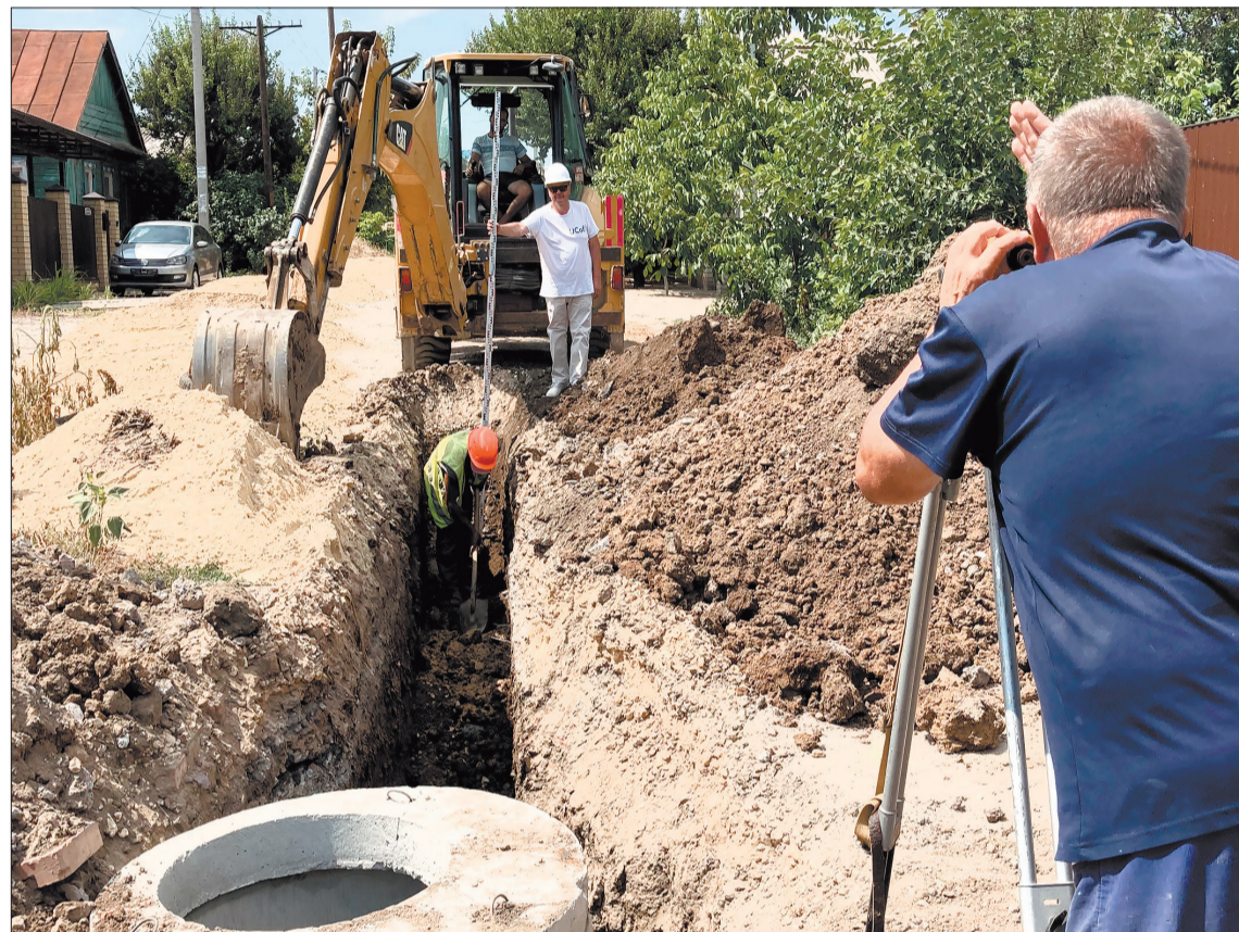
Прокладка канализации — не такое уж простое дело: стоки по трубе должны двигаться свободно, не застреваясь на поворотах.
