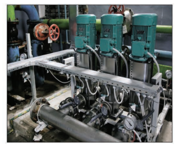
Внутри ЦТП находятся насосы, задвижки и теплообменники.
